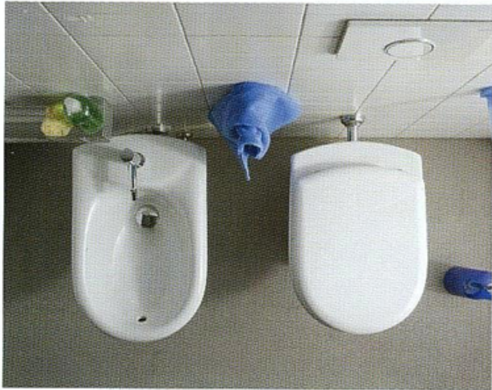
Vaso da sostituire
